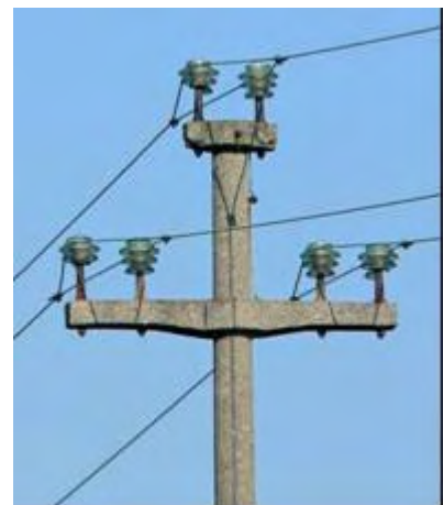
Fig. 11: Isolatore portante doppio.
