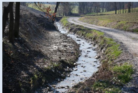
Nuova area allagabile ottenuta per risagomatura ed allargamento di sezione nel tratto collinare del Rio Enzola. La strada a destra è collocata all'interno dell'alveo originario.
