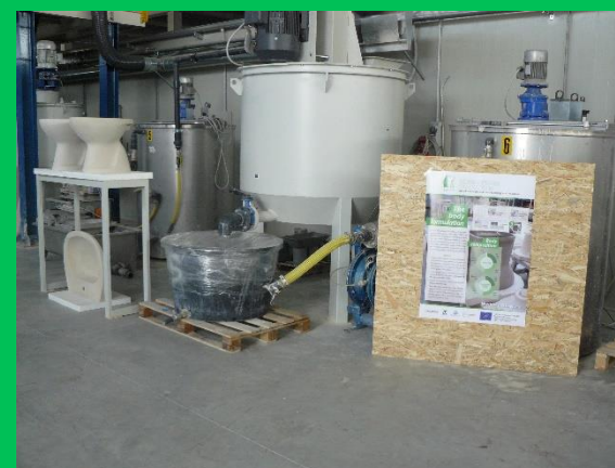
Foto 2, 3, 4 – Impianti pilota presso Minerali Industriali srl, GE.MI.CA. srl e SE.TE.C. srl (SANITSER Staff)
