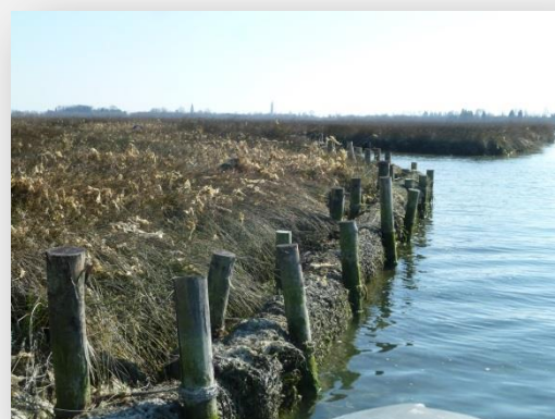
Fig. 3 – Fascine di LIFE VIMINE installate per proteggere le barene dall’erosione di onde e correnti (Foto: N. Modica)
