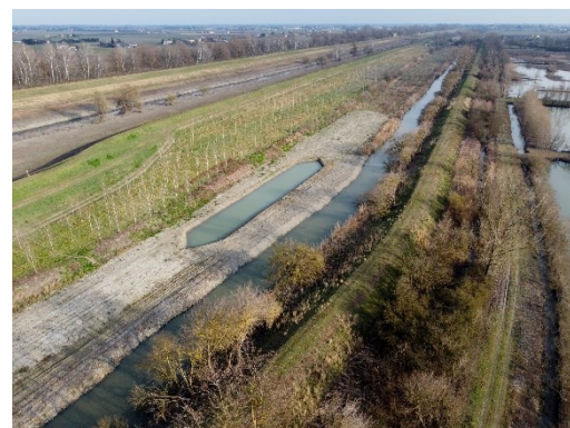
Figura 7: Stepping stone n° 9 in fase di realizzazione. Una bassura umida connessa al canale di bonifica permette il mantenimento di un'area caratterizzata dalle specie tipiche dell'habitat 91F0. (Foto: Silvia Aurino)
