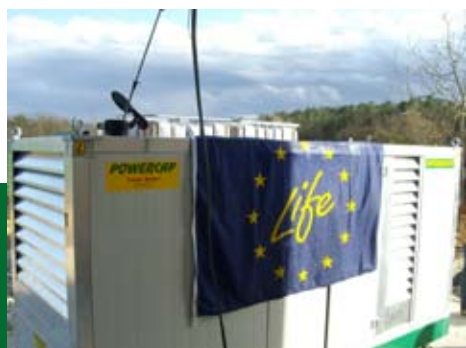
Generatore 50 kWe modificato per l'utilizzo di olio vegetale puro (Foto CREAR/Università di Firenze)
