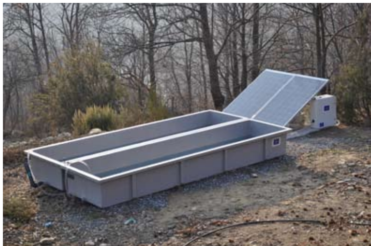
Foto 3 L' impianto: il pond è costituito da due vasche rettangolari a fondo piano in PRFV. Il sistema di ricircolo è composto da una pompa a corrente continua, alimentato da due batterie (in serie) caricate mediante due pannelli fotovoltaici (Foto Stefania Betti)
