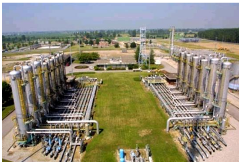
Fig. 9 Centrale trattamento – Colonne di disidratazione e piping dedicato
